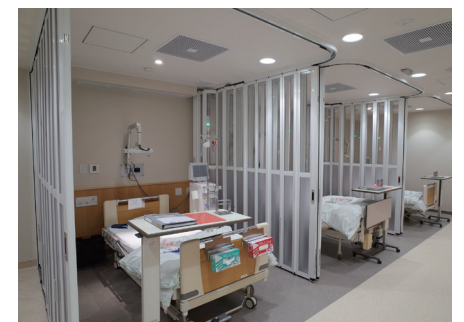
各ベッドブース内ごとに換気設備を設置した入院透析処置ブース
