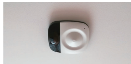
天井に設置された見守りセンサー本体
