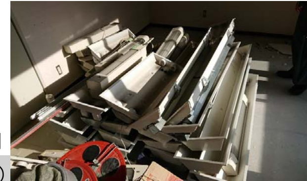
老朽化した蛍光灯照明器具
