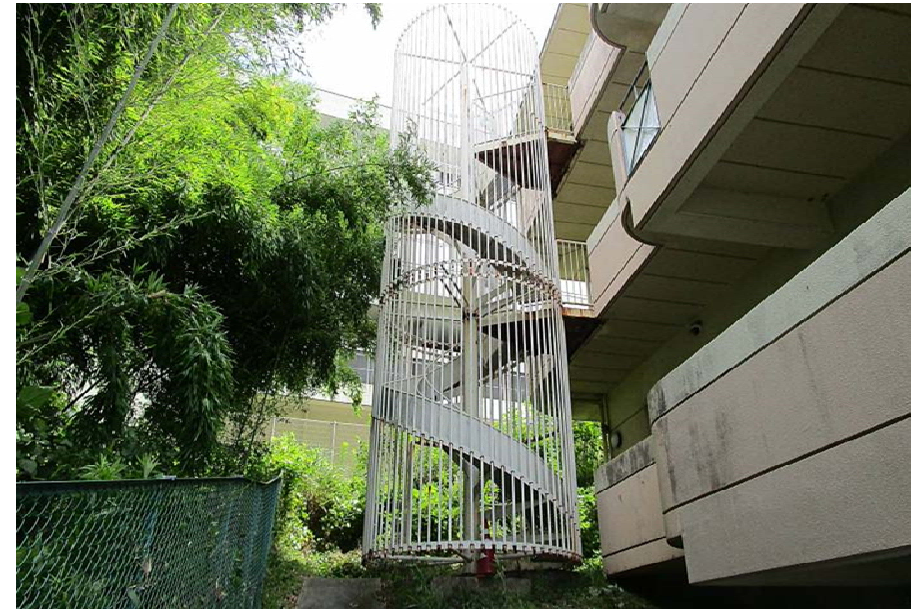
屋外避難滑り台
