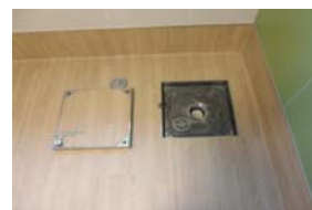
蓋付き排水設備
