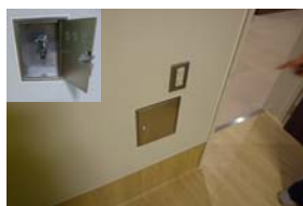
散水栓ボックス
