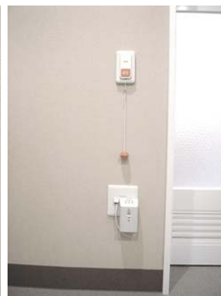
浴室のコンセントコール
