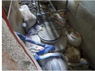
仮設汚水ポンプ。
