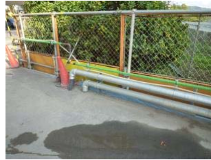
仮設消火設備（送水口）、 仮設医ガス。
